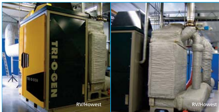
165 kWe ORC van Tri-O-Gen op de uitlaatwarmte van 2MWe gasmotor bij rozenkwekerij 'Olij' in De Kwakel, Nederland.
