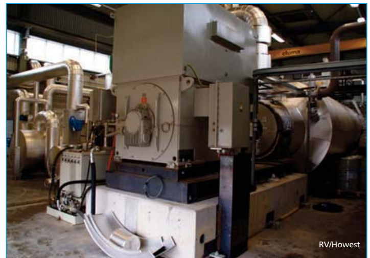
2,5 MWe ORC-installatie van Turboden op overschotten warmtenetwerk bij afvalverbrandingsinstallatie MIROM, Roeselare.
