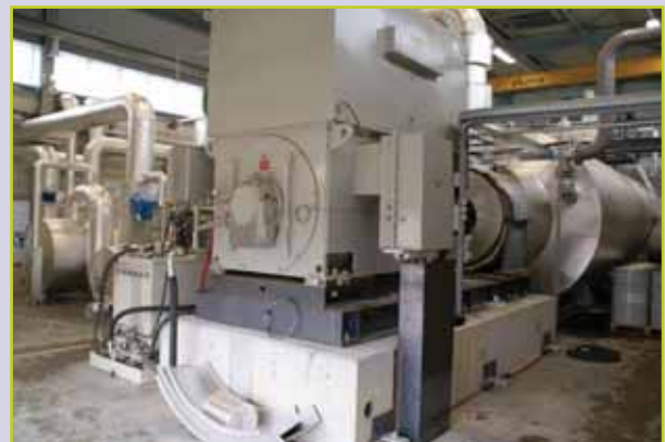
Figuur 2: 165 kWe ORC van Tri-O-Gen op de uitlaatwarmte van 2 MWe gasmotor bij rozenkwekerij 'Olij' in De Kwakel, Nederland.
