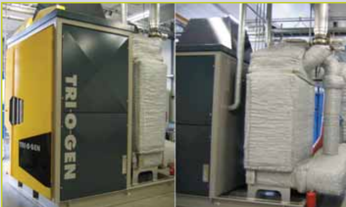
Figuur 3: 2,5 MWe ORC-installatie van Turboden op overschotten warmtenetwerk bij afvalverbrandingsinstallatie MIROM, Roeselare.
